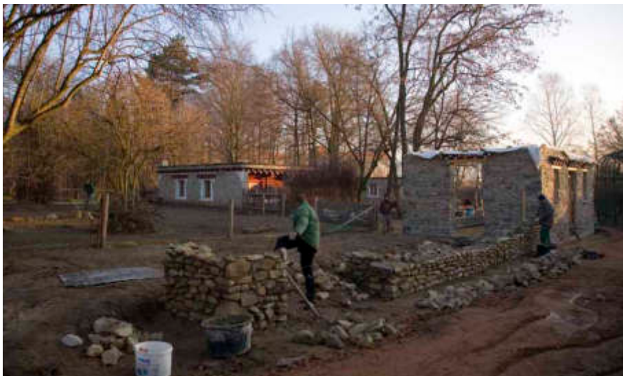
Kamelhaus im Bau. Das fertige Gebäude ist wieder aus Naturstein und Holz gefertigt und einem Gebäude in der Region um Dartsedo nachempfunden.
