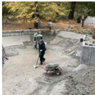
Teichbasis aus Beton
