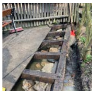
Marode Unterkonstruktion Ottersteg
