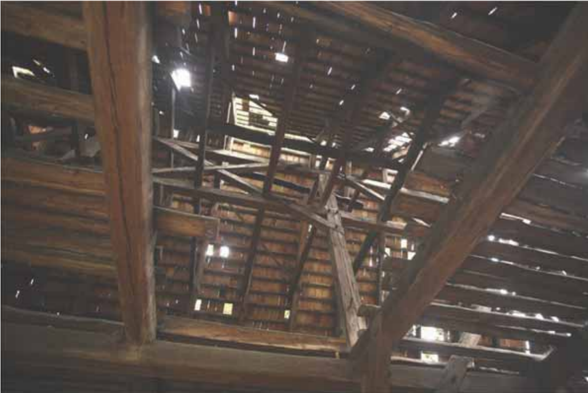
Abb. 26 Das desolate Dach der Schrotholzschene in Zeißig bei Hoyerswerda im November 2010
